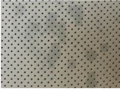
Manchas causadas por humedad. Sólo un tintado profesional puede resolver el problema. A veces los bordes permanecen visibles
