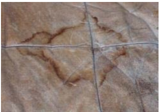
No es posible limpiarlo. Muchas manchas.
